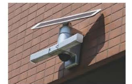
生産技術センター従業員通路外灯
