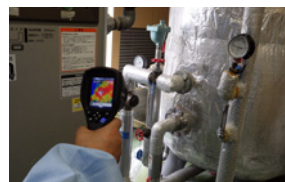
サーモグラフィによる放熱確認
