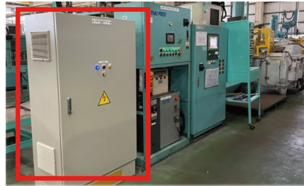
鋳造機制御盤と油圧ポンプモーターの間に本装置を設置
