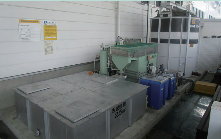
中間排水処理施設
